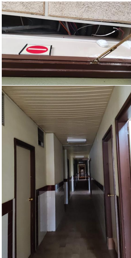
Vista del passadís pel qual passen actualment les canonades d'aigua freda i calenta en contacte.
