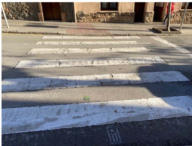
Vista al pas de vianants mal ubicat
