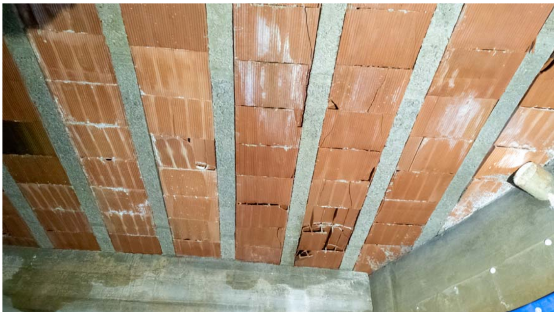
Imatge 1: Part interior forjat coberta – Revoltons ceràmics a retirar
