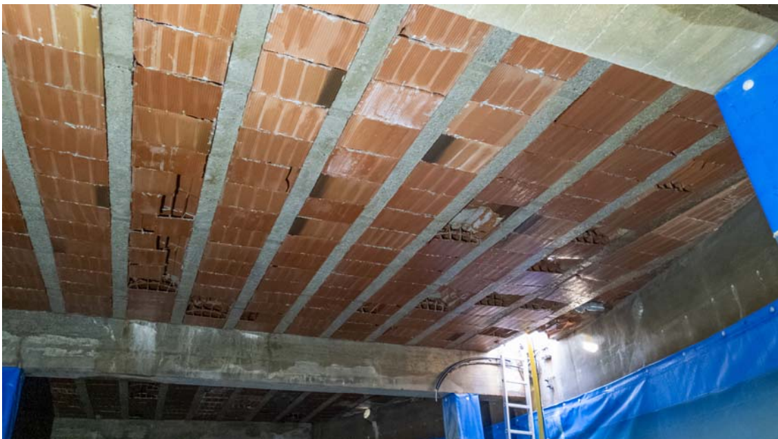
Imatge 3: Part interior forjat coberta – Revoltons ceràmics a retirar
